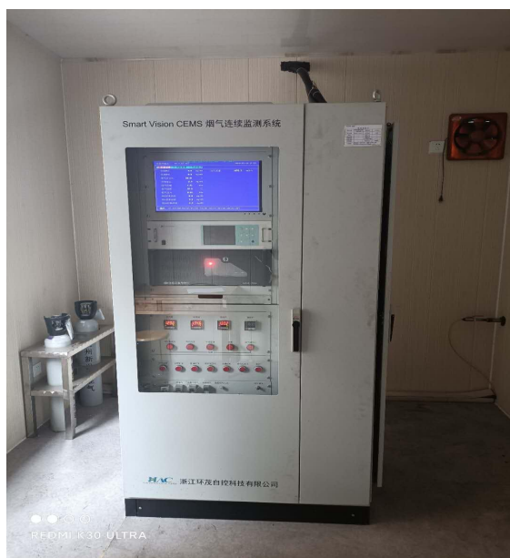
图 3.2.18-15 固废焚烧炉废气在线系统
