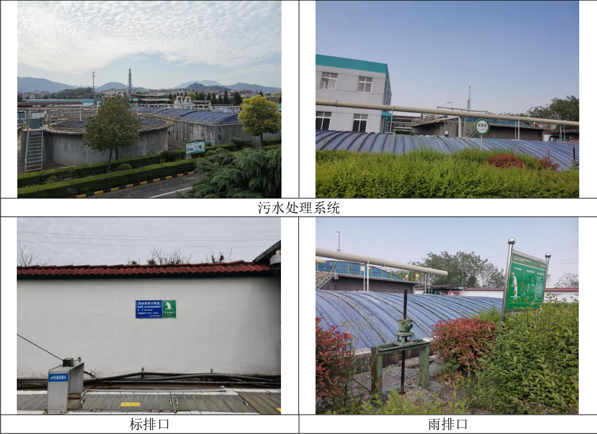
图 4.1-2 废水处理设施现场照片
