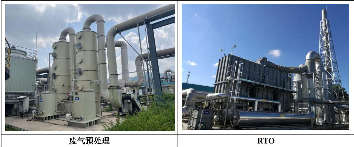
图 4.1-4 废气处理设施现场照片
